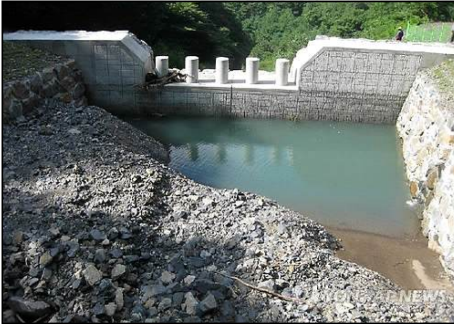
그림 3.48.2 중남 보령시 청라면 성주산 기슭에 설치된 사방댐 전경, 퇴적토 관리를 위한 대책이 필요하다
